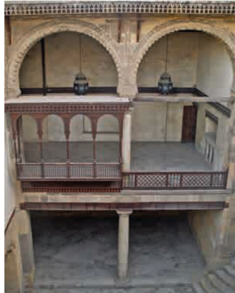
Planche n° 28 : La façade du « maq'ad » et du « takhtabush » donnant sur la cour d'honneur.
