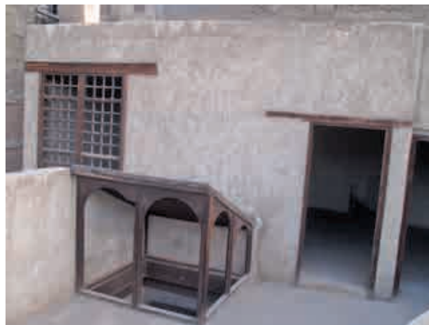
Planche n° 83 : La salle du deuxième étage dans la section du harem sur laquelle s'ouvrent deux chambres. La fenêtre de l'une d'entre elles donnant sur la cour secondaire apparaît sur la photo.
