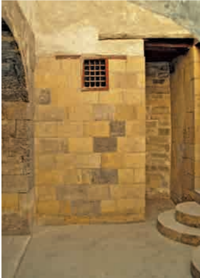
Planche n° 41 : Les locaux de service, le siège d'aisances à l'angle ouest de la cour secondaire, avec son étroite fenêtre supérieure qui apparaît.
