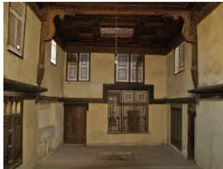
Planche n° 71 : La grande salle, la « dorqa'a », une paire de poutres en bois insérant entre elles une passerelle qui sépare les deux plafonds de l'iwan et de la « dorqa'a ».
